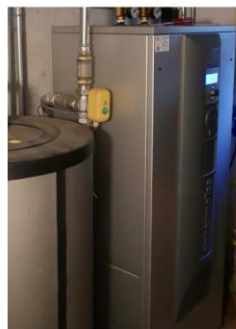
Warmtepomp zonder aardgas. Rechts de warmtepomp, links een boiler.
